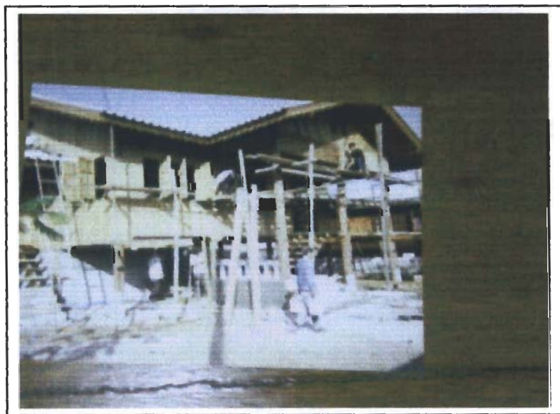
รูปภาพที่ 3.10 การก่อสร้าง ณ ที่ตั้งแห่งใหม่
