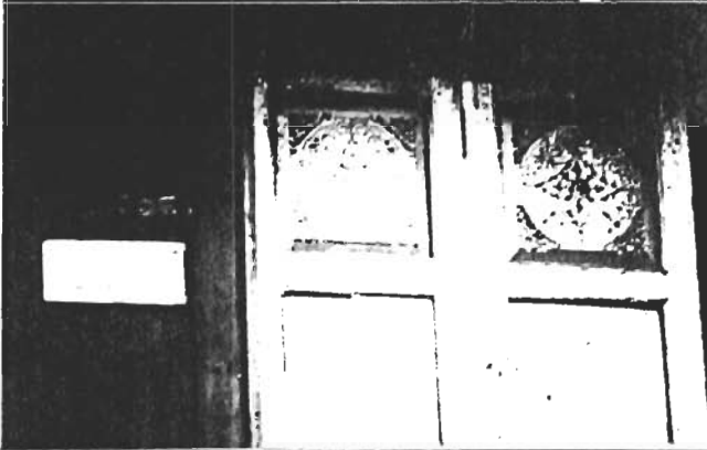
ภาพที่ [ 2.1.7 ] ช่องแสงไม้ฉลุ ผนังอาคารด้านทิศตะวันตก
